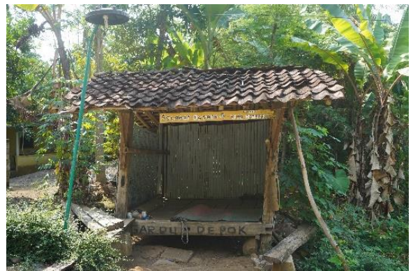
Gambar 3. Bangunan posko penerima wisatawan Kuda Sembrani yang terlihat tidak terawat dengan kurang layak.
